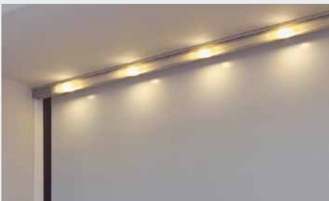
Светодиодная планка установлена на перемычке
